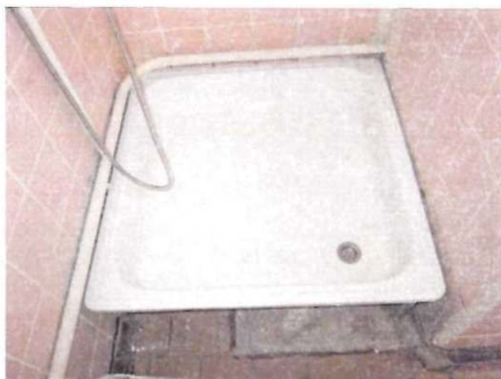
Фото № 27 Душевая комната Фото (поддон для мытья ног)
